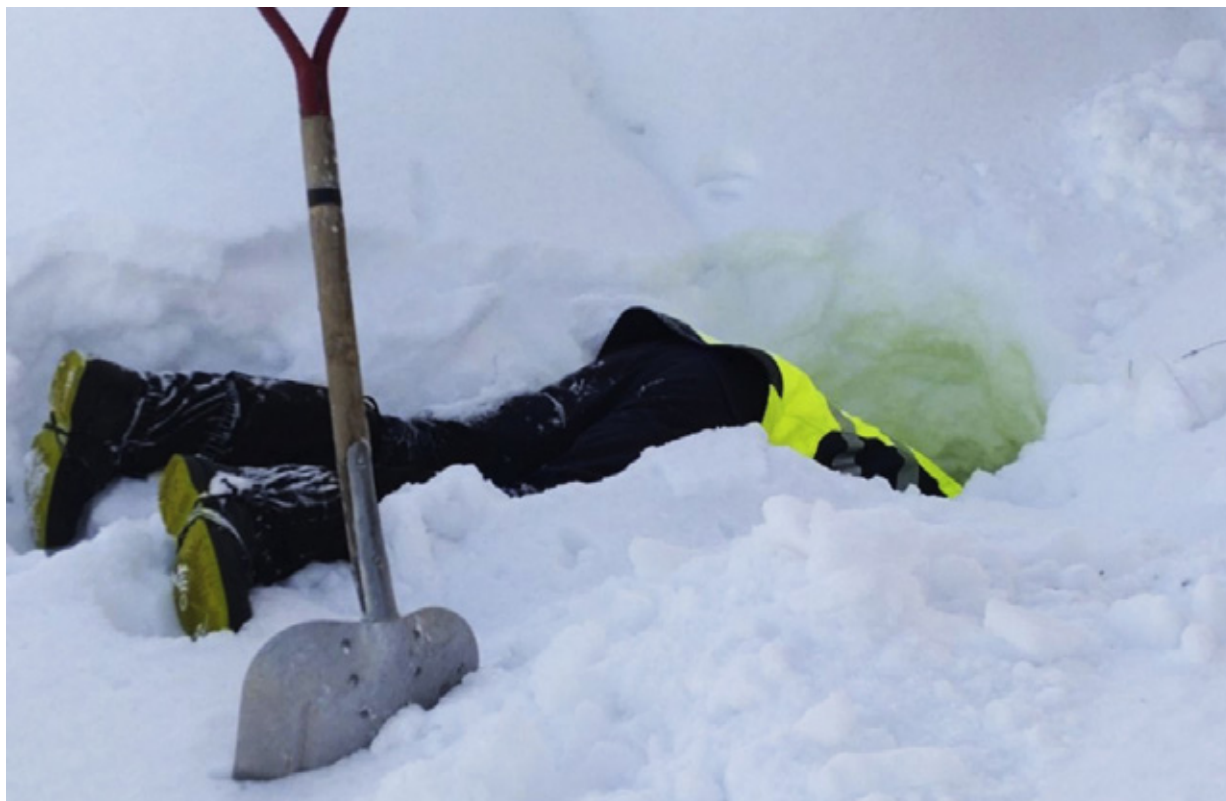
Søk etter kabelfeil.
