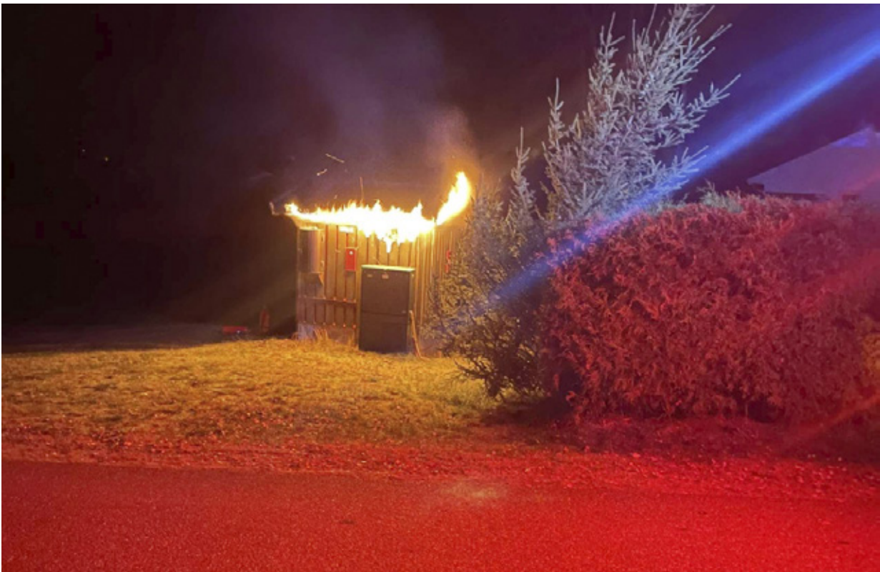
Brann i nettstasjon.
