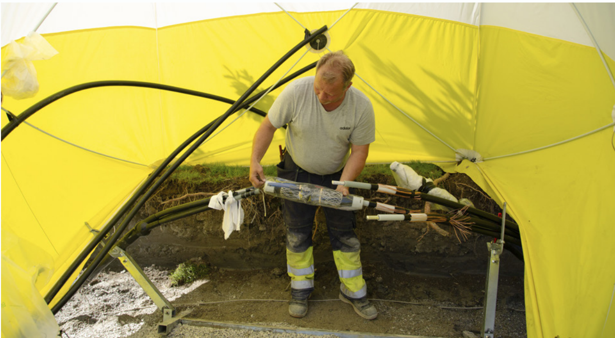
Skjøting av høyspent for trafo til ny elbilladestasjon på YX Vikersund, foto: Trond Lindseth
