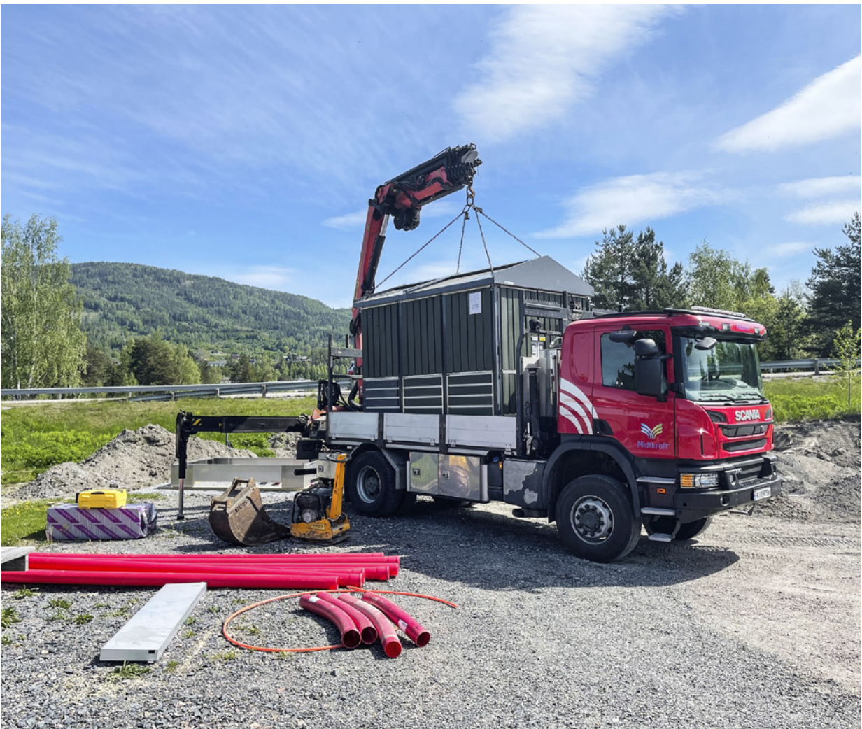
Ny trafo til hurtigladestasjon for elbiler i Vikersund, foto: Kople
