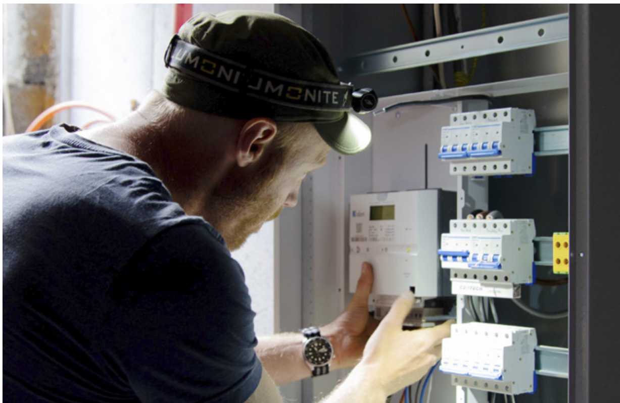
Jens Kristian Støa monterer ny måler etter at gårdsbruk har forsterket inntaket på Velstad i Sigdal, foto Trond Lindseth
