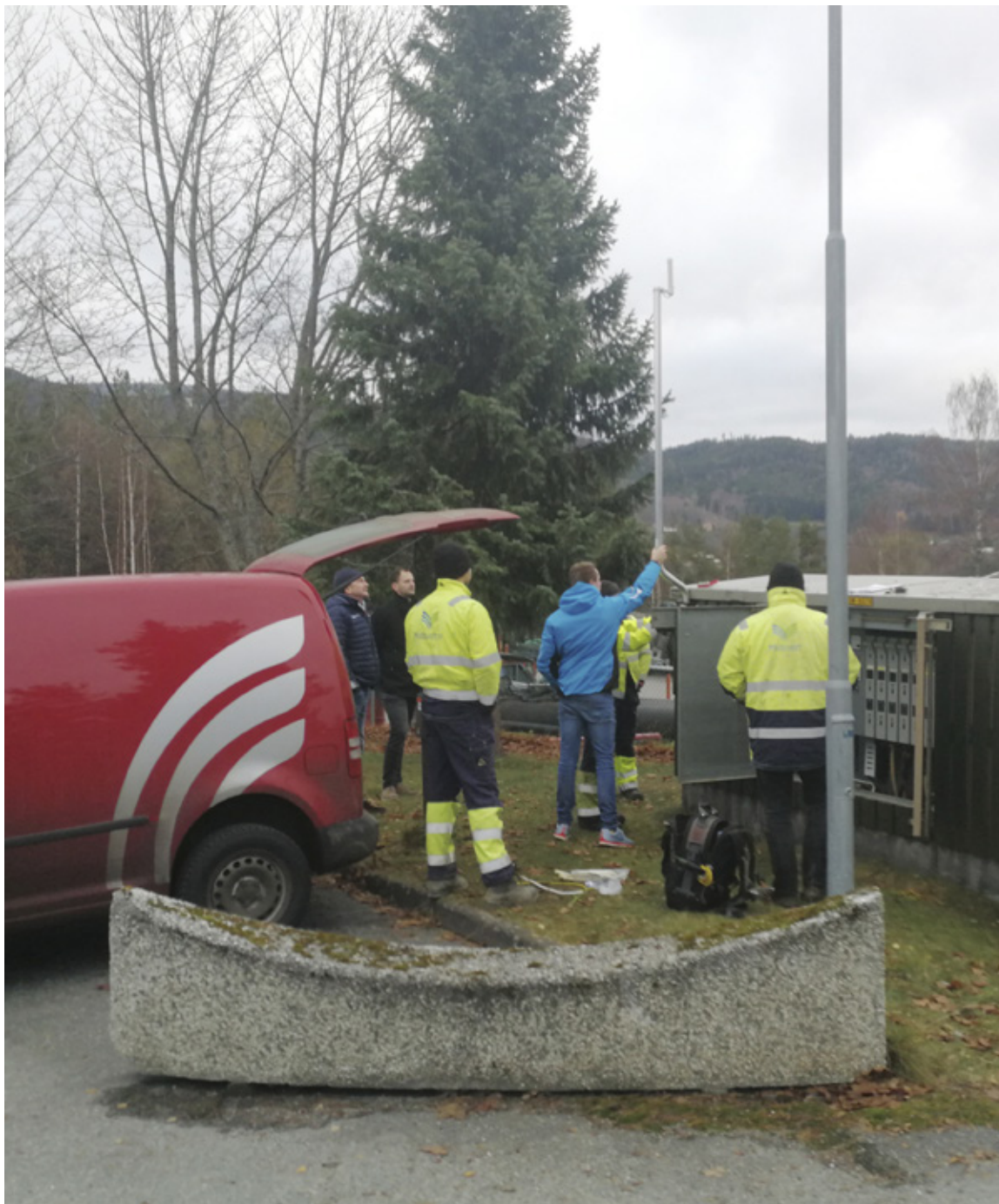
Første montering av AMS skap (mottakeren i trafostasjon for data fra nye målere). Foto: Jens Kristian Støa
