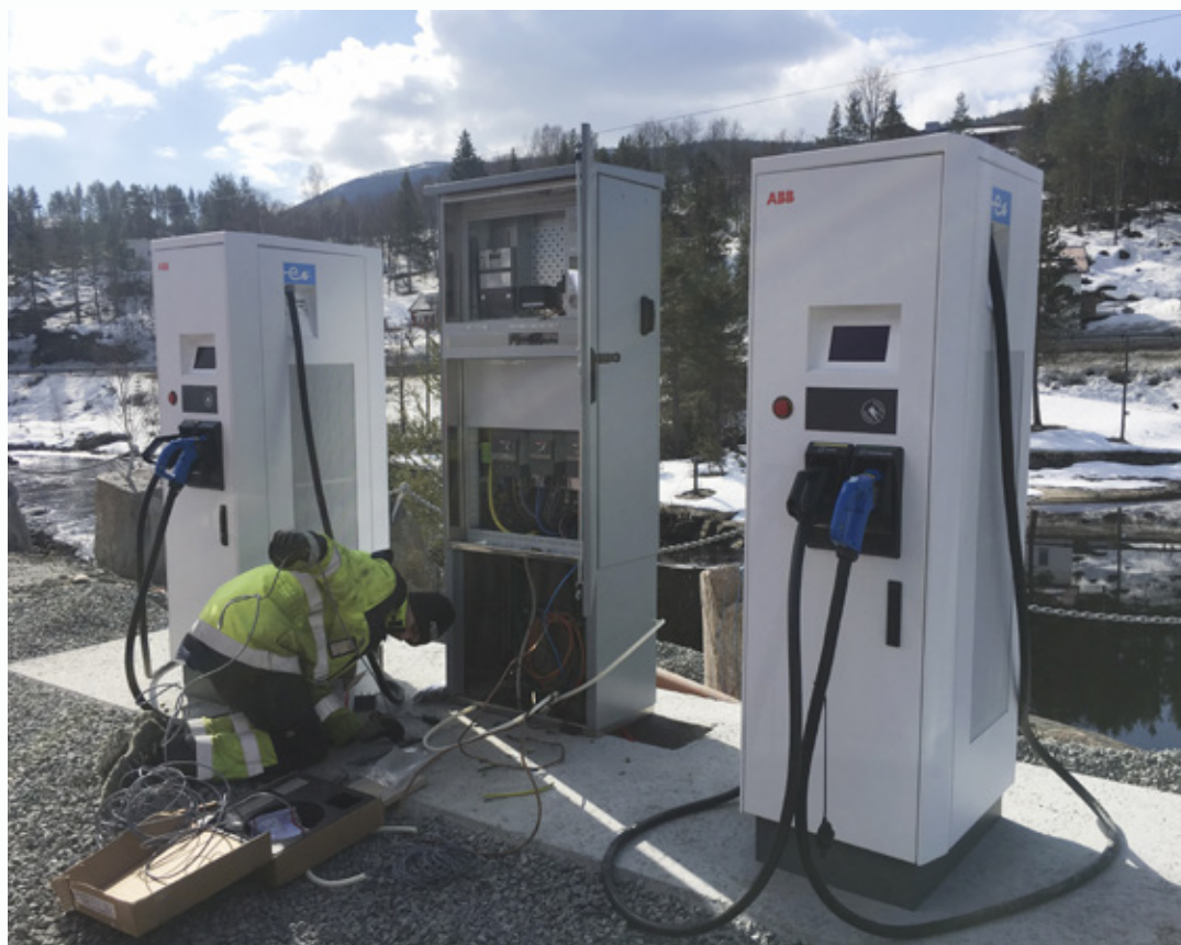
Tilkobling av hurtigladdestasjon i Prestfoss . Foto: Trond Lindseth
