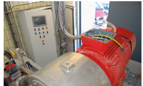
Det er ikke stor plass inne i Sønstebym kraftstasjon
