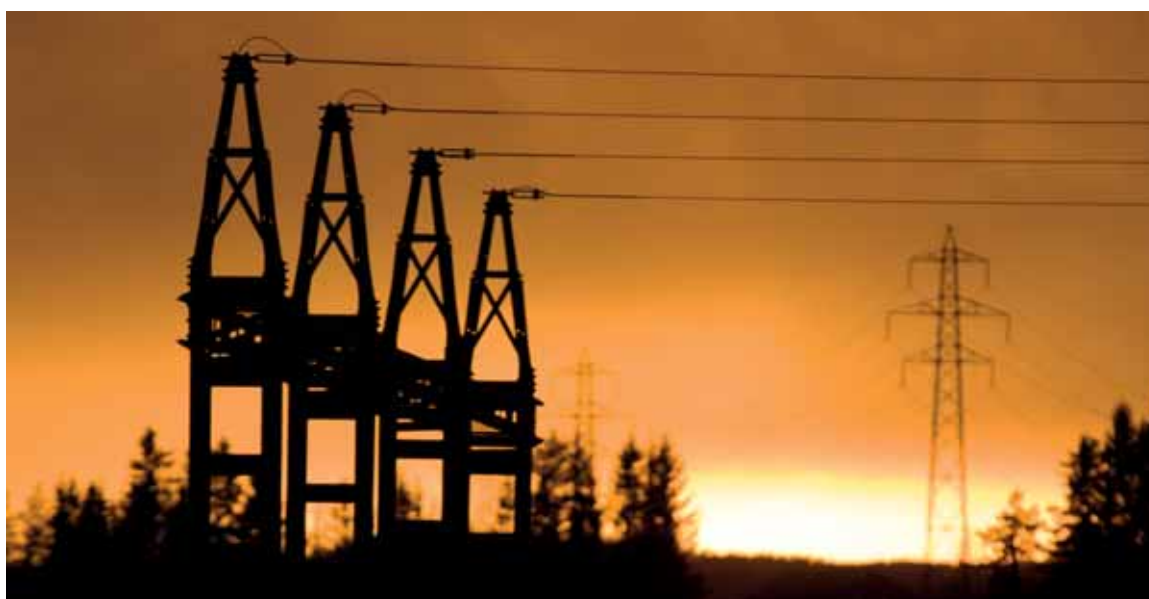
Høyspentmaster på Hovde trafostasjon, foto Erik Thalerud.
