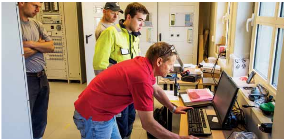
Oppstart av nye Sundbakken Trafostasjon, foto Erik Thalerud.
