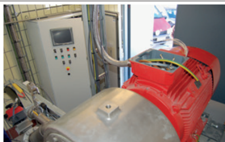
Det er ikke stor plass inne i Sønsteby kraftstasjon
